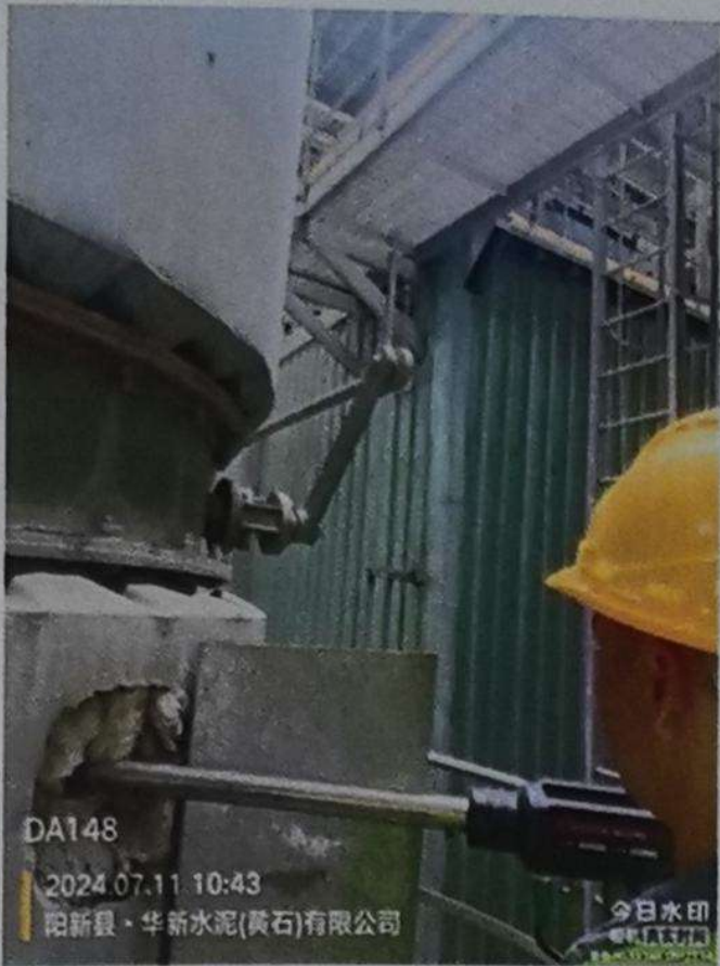
DA148 2#水泥磨球磨机排气筒采样口◎9
